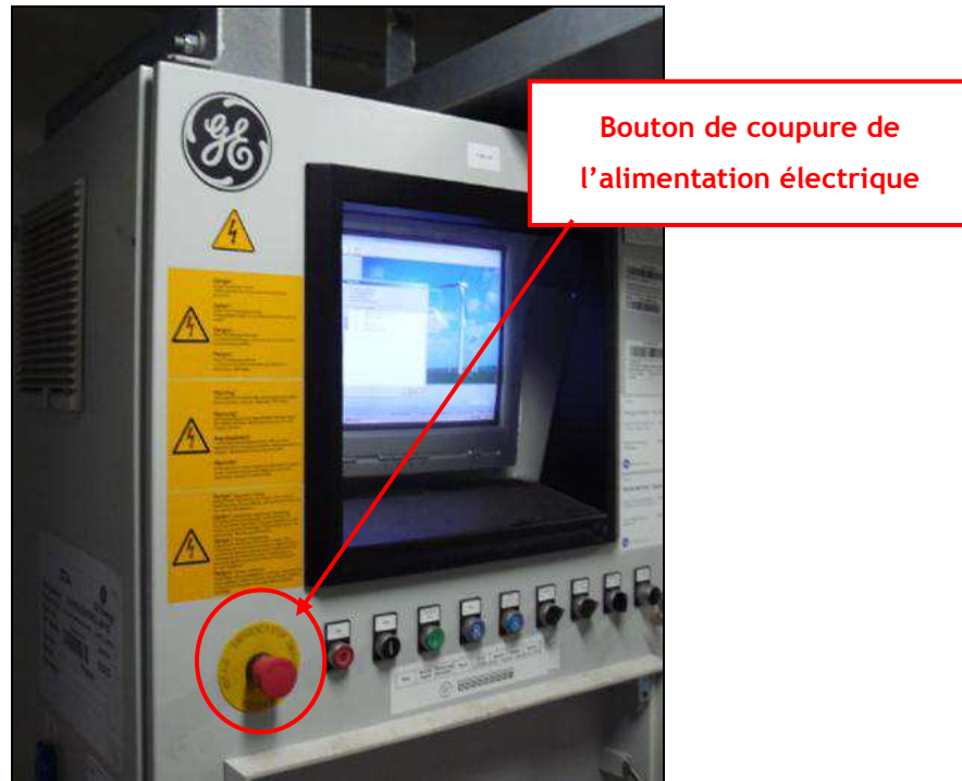
Figure 17 : Exemple de dispositif de coupure au niveau d'une armoire de contrôle d'une turbine (source : VALOREM)
