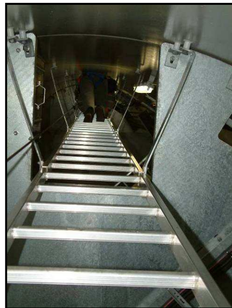
Figure 16 : Intérieur du mât d'une éolienne - Echelle d'accès (source : VALOREM)
