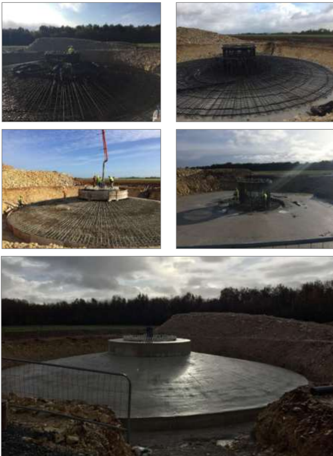
Photographie 54 : Exemples de travaux pour la construction des fondations des éoliennes sur le projet éolien de Limalonges dans le département des Deux-Sèvres en 2020 (source : wpd onshore France)
