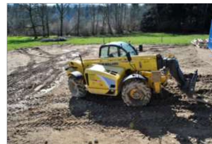
Photographie 57 : Exemple de tassement et d'ornières créés par les engins de chantier
