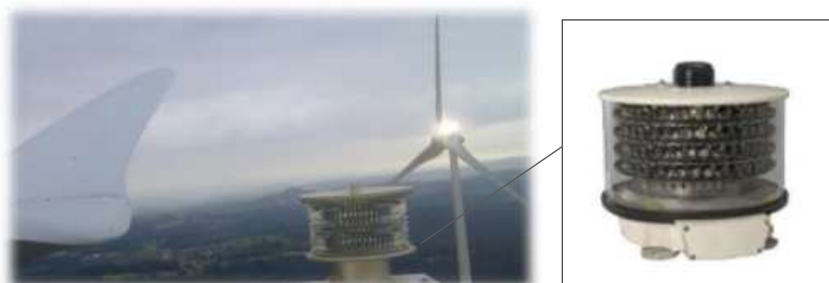
Figure 36 : Balisage d'une éolienne
