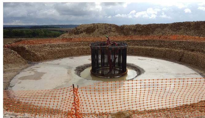
Béton de propreté, bride d'ancrage et fourreaux de réservation pour les câbles
