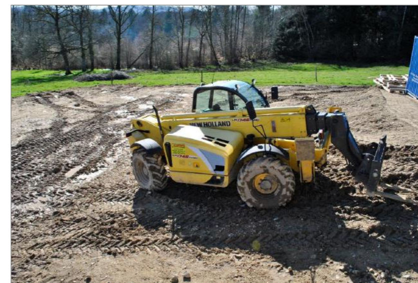
Photographie 33 : Exemple de tassement et d'ornières créés par les engins de chantier
