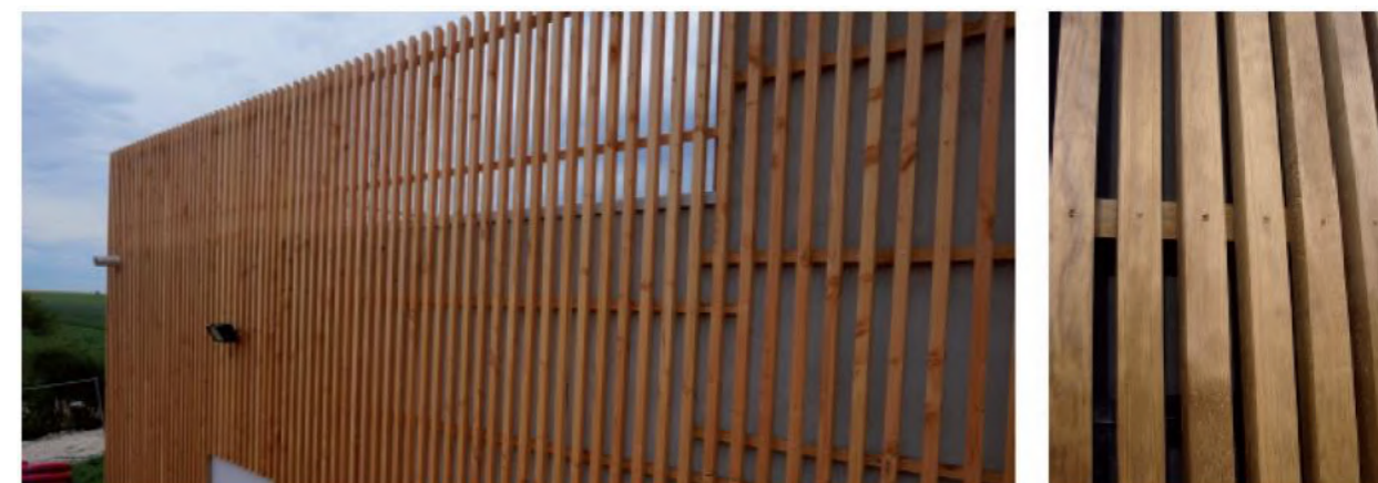
Photographie 44 : Exemple de bardage bois à claire-voie vertical garantissant l'intégration paysagère du poste de livraison tout en évitant l'installation des chiroptères attirés par le confinement
