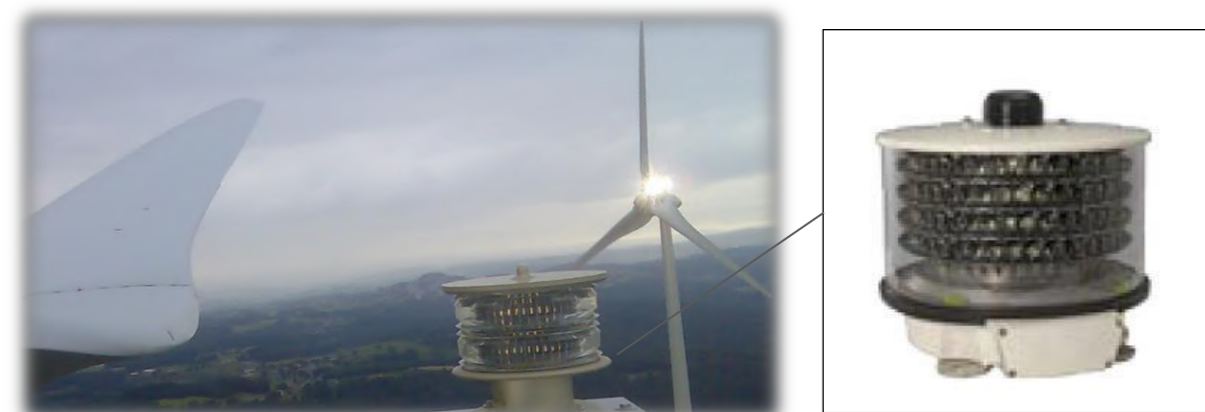
Figure 42 : Balisage d'une éolienne
